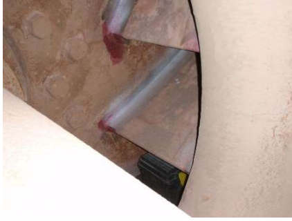
Figura 4. Fotografía de los álabes del ventilador. Se puede observar parte de la carcaza.
