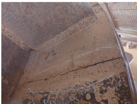
Figura 1. Se puede observar la fisura extendida que presenta la brida de salida
