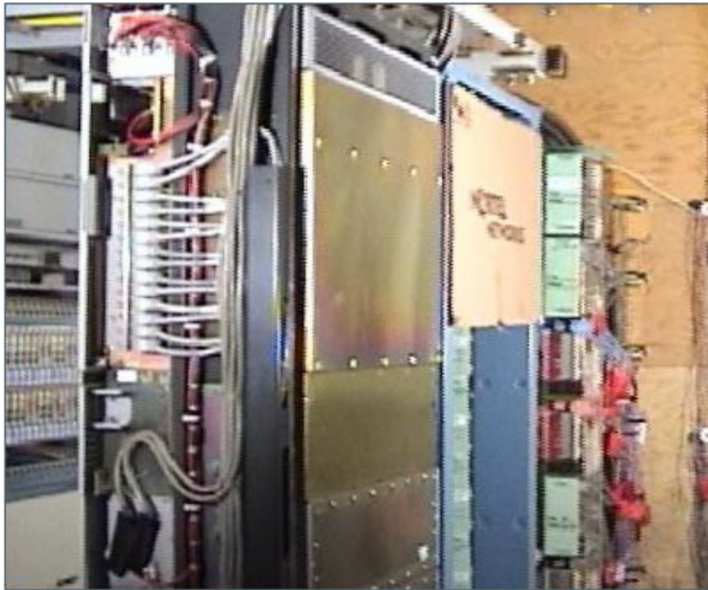
Figura 1 Sala de telecomunicaciones
