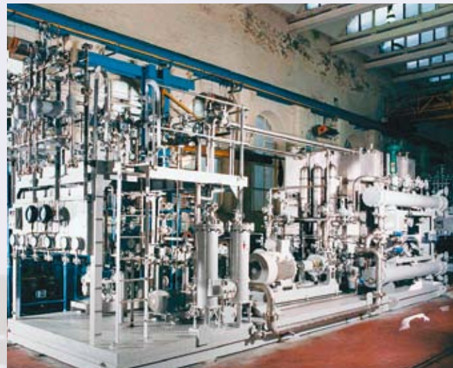
Refrigeración de aire comprimido
