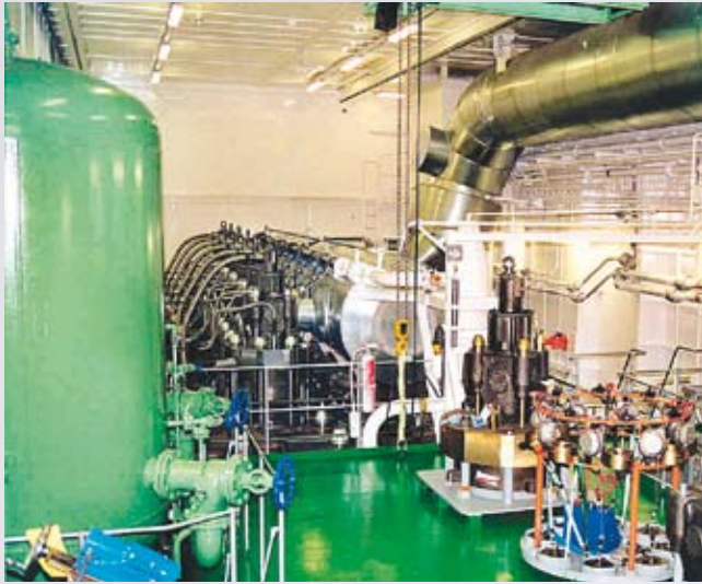
Refrigeración de motor de barco
