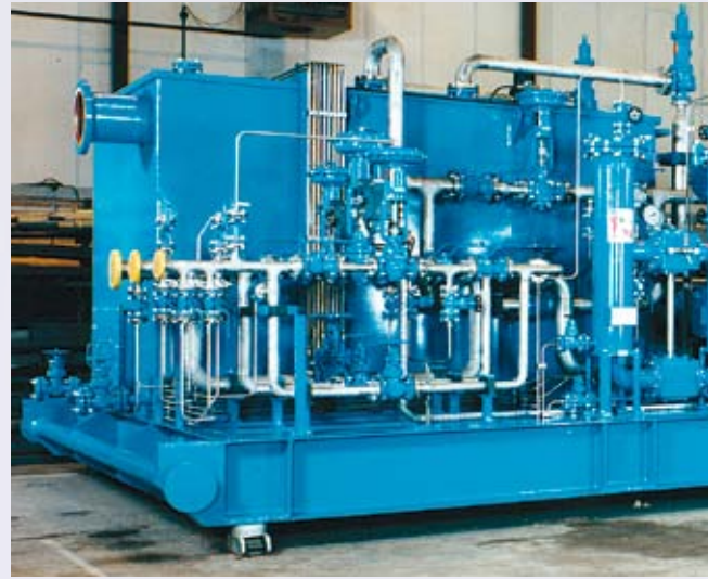
Refrigeración de lubricantes
