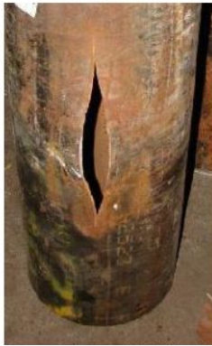
Figura 1.-Fotografía de un caño fallado de trampa de scraper de un poliducto (Autores: Perreti, Grenada y Cardacce)
