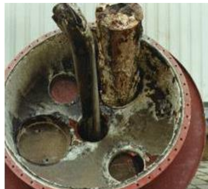
Corrosión rendija (crevice)
