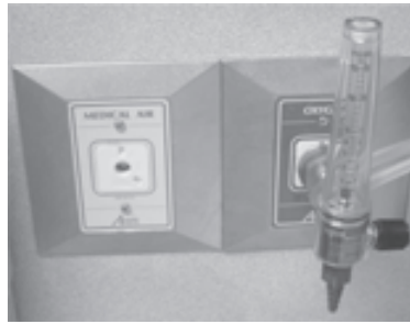
Las tomas médicas de gas se diseñan de tal modo que sólo puedan insertarse las válvulas adecuadas en únicamente una toma de salida.
