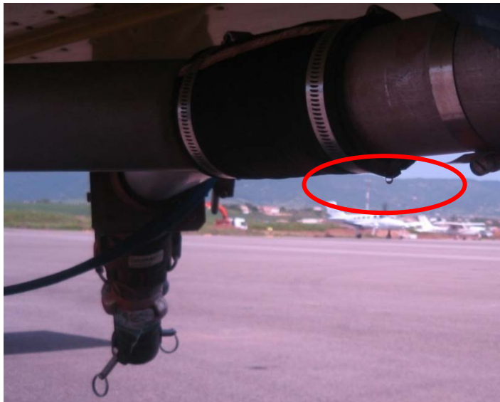
Figura 29. Junta de conexión entre tuberías con fugas apreciables.
