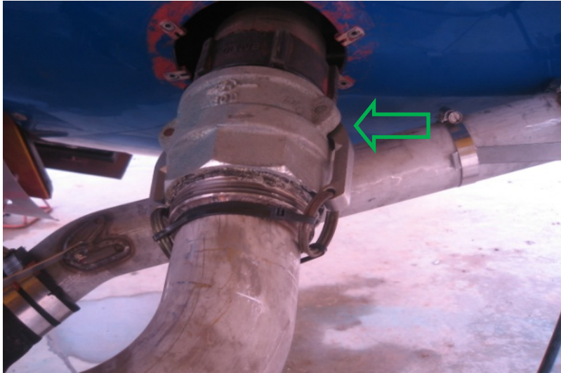
Figura 18. Tubería de aspiración de la bomba aprisionada mecánicamente sin riesgo de fugas o desconexión fortuita.
