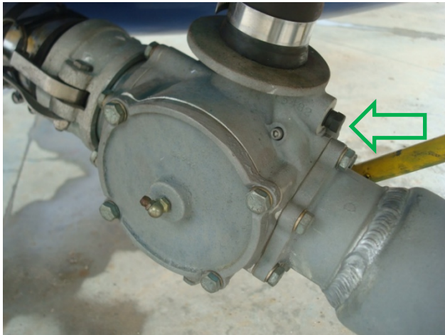
Figura 30. Válvula de tres vías con tornillo de retorno para regular la presión de aspiración.
